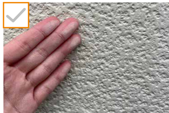
外壁材を触ると手に粉が付く
