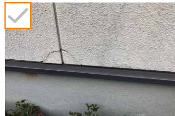
クラック(ひび割れ)・欠け
