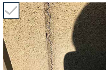
コーキング(充填剤)の劣化
