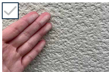
外壁材を触ると手に粉が付く
