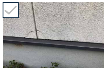
クラック(ひび割れ)・欠け
